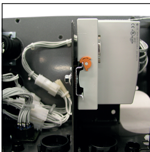
Feldbus-Koppler auf isolierter Hutschiene montiert
