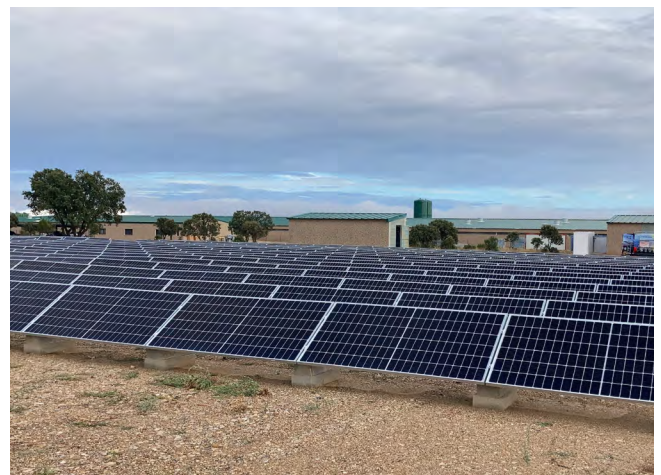
/ Módulos solares sobre suelo con sistema solarblock
